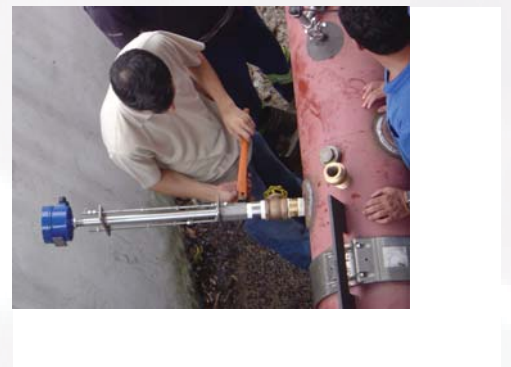
VMI sendo instalado na adutora da Sabesp no Alto da Boa Vista/SP
